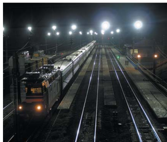
Рис. 6. Освещение: а) сортировочной станции «Новоярославская»; б) станции «Шексна» Северной железной дороги светодиодными светильниками на основе СД
