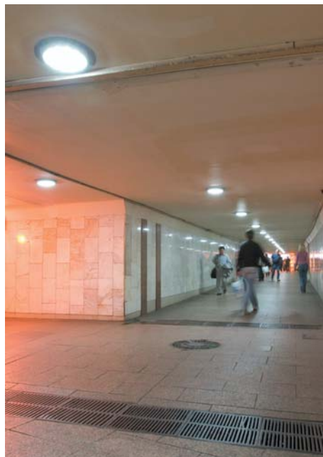
Рис. 5. Освещение подземного пешеходного перехода в Москве около станции метро «Рижская» светодиодными светильниками на основе СД (прямо) и натриевых ламп высокого давления (слева)
