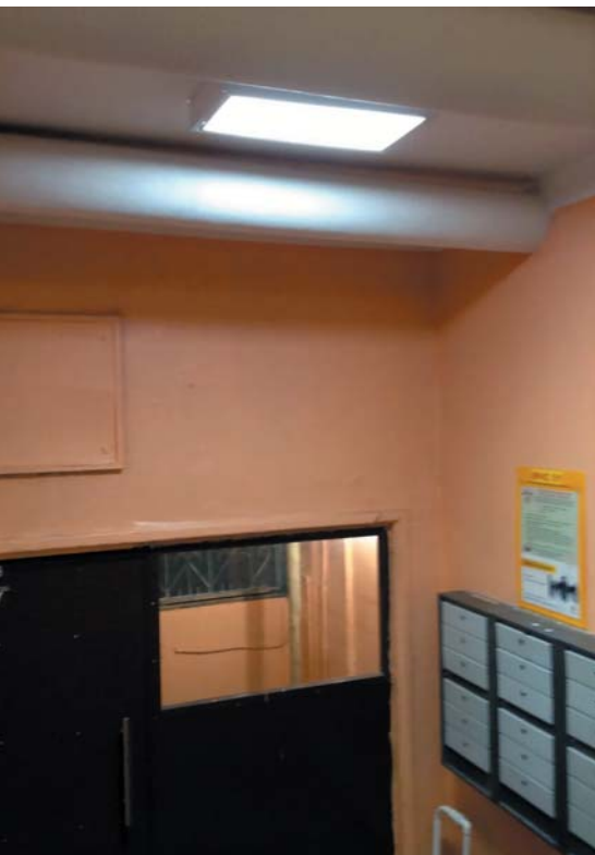
Рис. 10. Освещение в подъезде жилого дома светильником с лампой на основе СД мощностью 24 Вт
